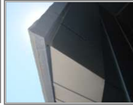
(شكل ٤٤) نهايات الكتل المعلقة بالمدخل ، وقد تم تثبيتها بالمسطح الخرساني أولاً ثم وضع الأسقف المعلقة بحيث لا يظهر للرائي وسيلة التثبيت
